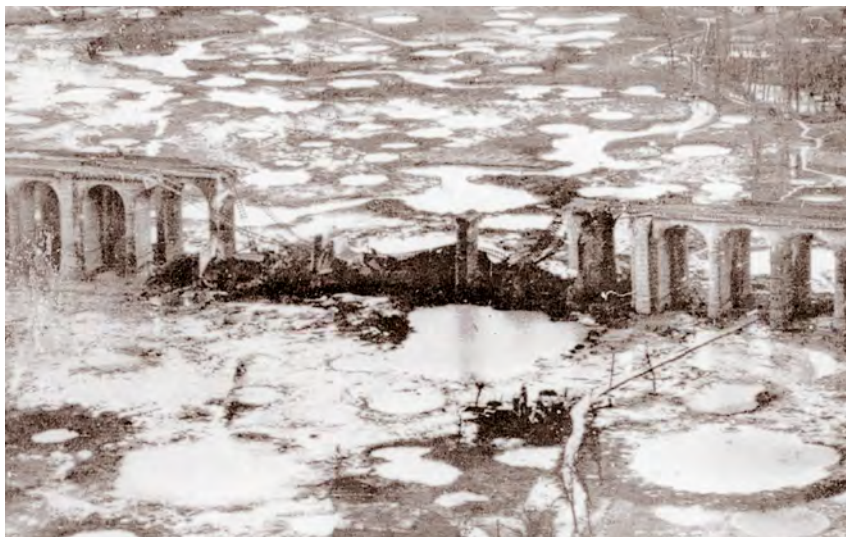
Foto van het viaduct op 17 maart 1945. De aardbevingsbom heeft ca. 250 meter van het viaduct doen instorten.
