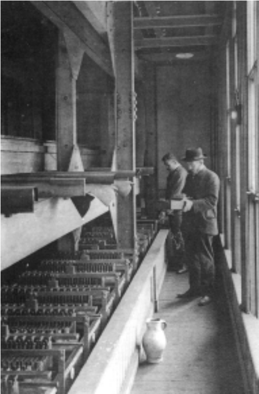
Blik in de accukamer van een gelijkstroomcentrale, in dit geval in Rotterdam. Links de rijen plaataccu's. Deze waren van hetzelfde type als nu nog in auto's worden gebruikt, alleen waren ze veel langer om 220 in plaats van 12 volt te kunnen leveren. De kan op de voorgrond diende om het zwavelzuur in de accu's aan te vullen (Licht op het GEB, p. 101).
