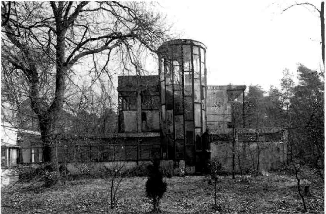
Het Dresselhuyspaviljoen, waarvan hier de zuidelijke vleugel, is nog steeds in bijna oorspronkelijke staat te bezichtigen. Maar het is al jaren niet meer in gebruik en door gebrek aan onderhoud technisch gezien in zeer slechte conditie.
